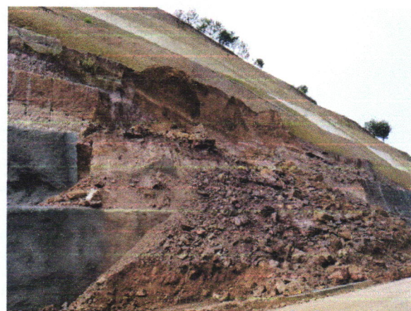
Imagen No. 2, Deslizamiento de suelos y bloques de roca.
