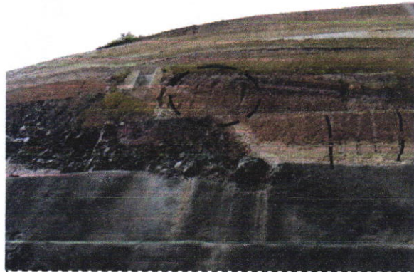
Imagen No. 4, Cárcavas y fracturas en los taludes aledaños.
